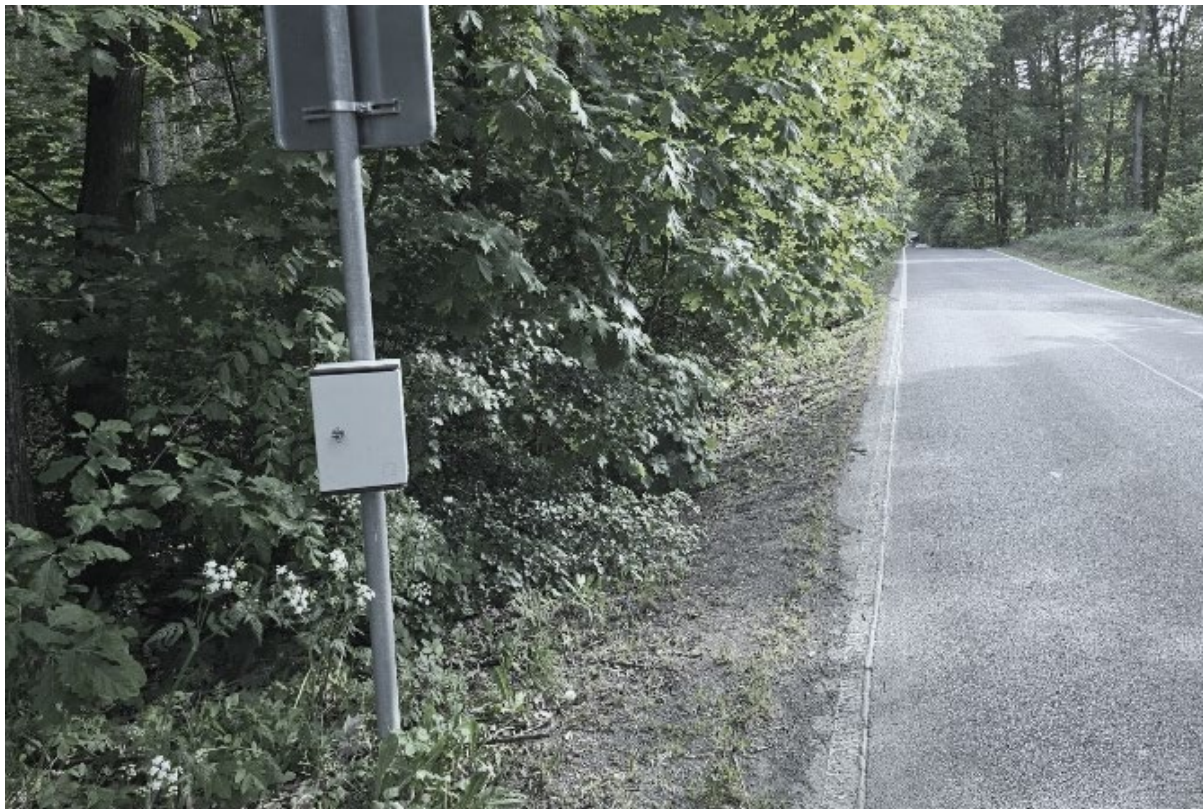
Obr. 3: Profil 1 – Měřicí zařízení (radar) 3
